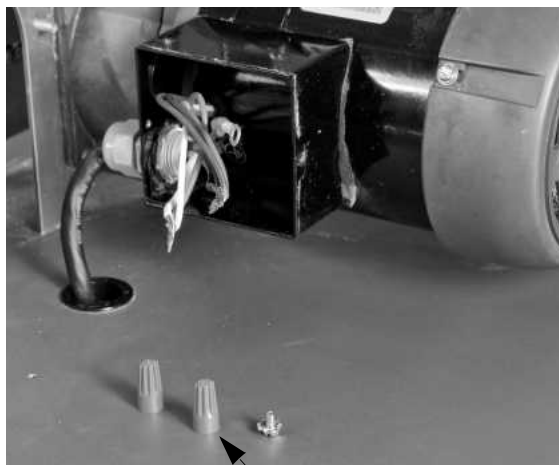
Tuercas de empalme de cables
