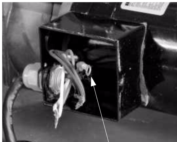
Câble de terre vert
